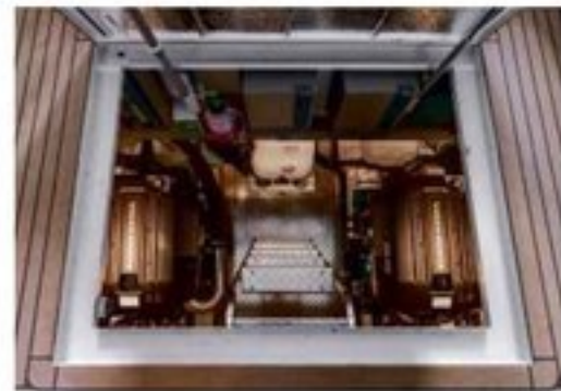
Der Zugang zum Motorenraum: Die Motoren sind für Yachttechniker gut zu erreichen. Alle Servicearbeiten können mit viel Platz ausgeführt werden
